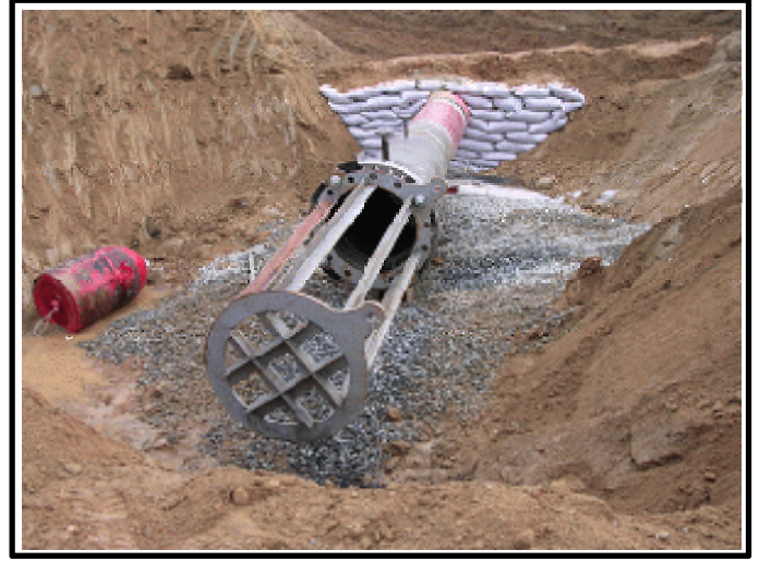
설치 된 PIG 회수 장치
