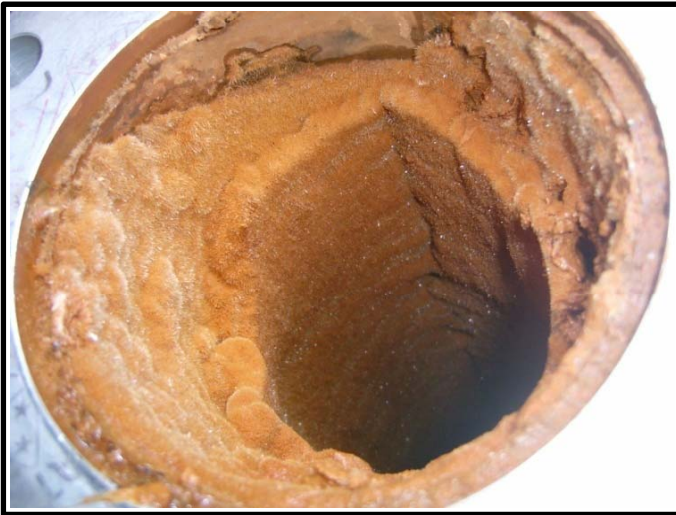
CLEANING 대상 배관 내부
